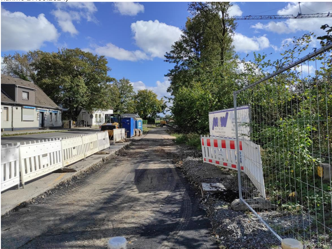
Abbildung 9: Blick entlang der Zeppelinstraße in Richtung Osten auf den in der Bearbeitung befindlichen Fuß-/ Radweg, Kanalbauarbeiten und den vorhandenen Gehölzgürtel im Straßenbegleitgrün (eigene Aufnahme 27.09.2024)
