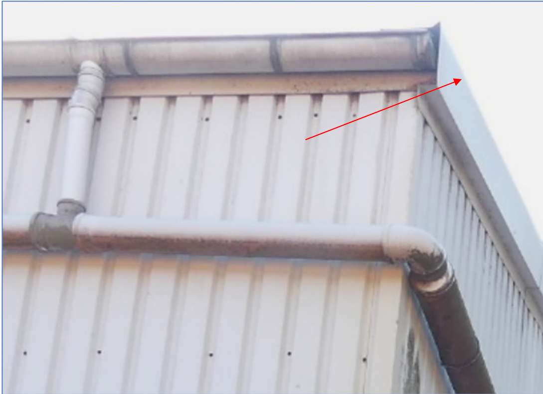
Abb. 8: Nistmöglichkeiten an Metallverkleidung des Flachdachs der Hockey- und Tennishalle (roter Pfeil) (Foto: ILP 2022)
