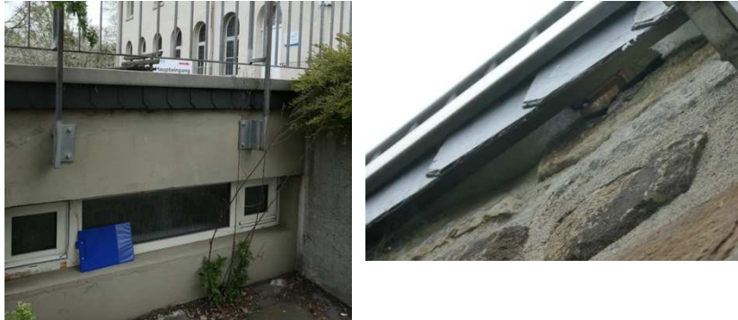
Abbildung 29: Spalten unter Schieferverkleidung an der Terrasse
