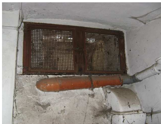
Abbildung 10: Kellerfenster mit Gitter davor, Zugang nicht möglich
