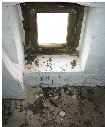
Abbildung 6: Geschlossenes Dachbodenfenster, davor viele verendete Insekten
