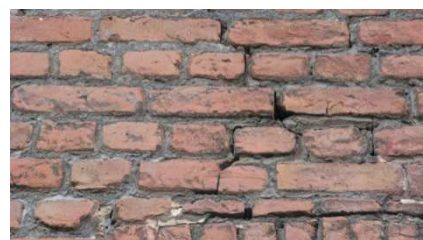
Abbildung 14: Spalten und Risse an der Fassade
