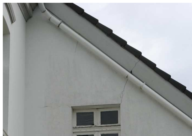
Abbildung 4: Riss am Ortgang an der Westseite
