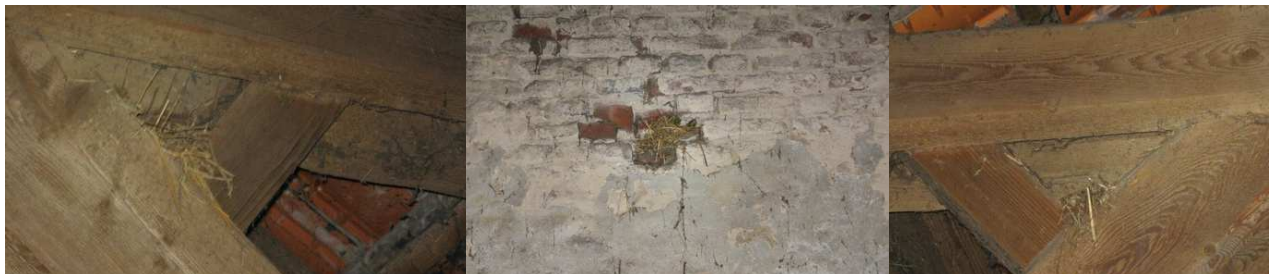
Abbildung 22: Alte Nester im Gebälk und Mauernische in der Scheune
