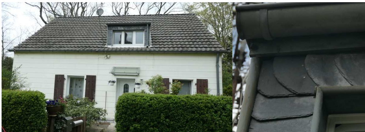
Abbildung 33: Wohnhaus Familie Götz, Spalten zwischen Dachrinne und Schieferverkleidung (rechts)
