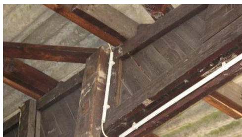
Abbildung 24: Spalten im Mauerwerk (oben) und in der Balkenkonstruktion (unten)
