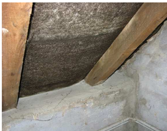
Abbildung 9: Eingegossene Dachbalken, kein Zugang zu den unteren Etagen
