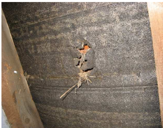
Abbildung 7: Vogelnest in defekter Teerpappe
